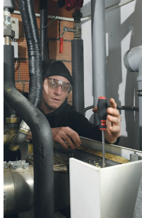
^ Geduld und Präzision: Darauf kommt es bei der Wartung von Heizungen an.
